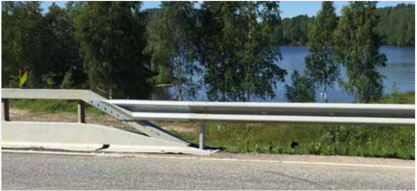
'Vegkant; Ensidig overgang VG-W rekkverk
